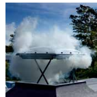
Sistema de evacuación de Humos y Carlor, CSP Pág. 16
